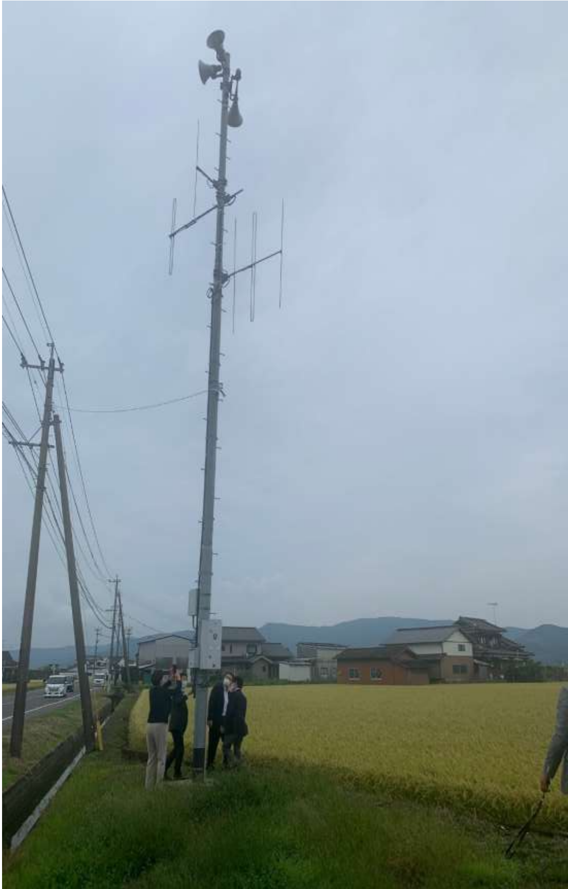
拡声子局設置建柱(アンテナが多い)
