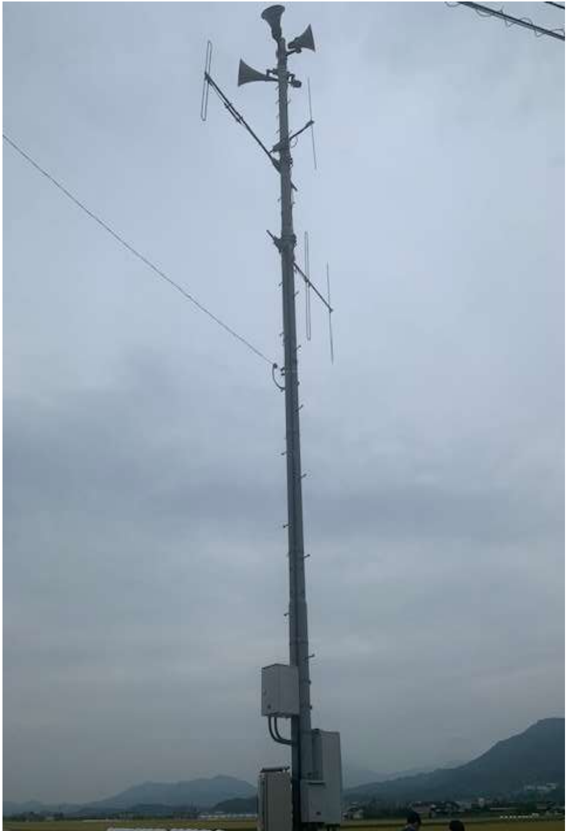
拡声子局設置柱(アンテナが多い)
