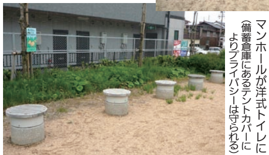
松本市の防災公園の設備
