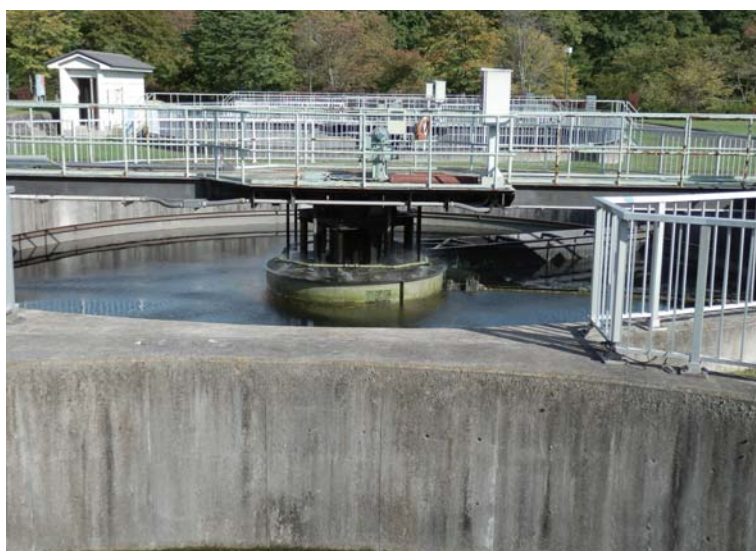
劣化が進んでいる
