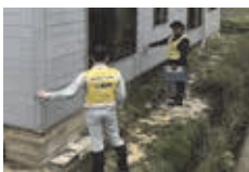
建物被害認定調査 (長野県飯山市)
