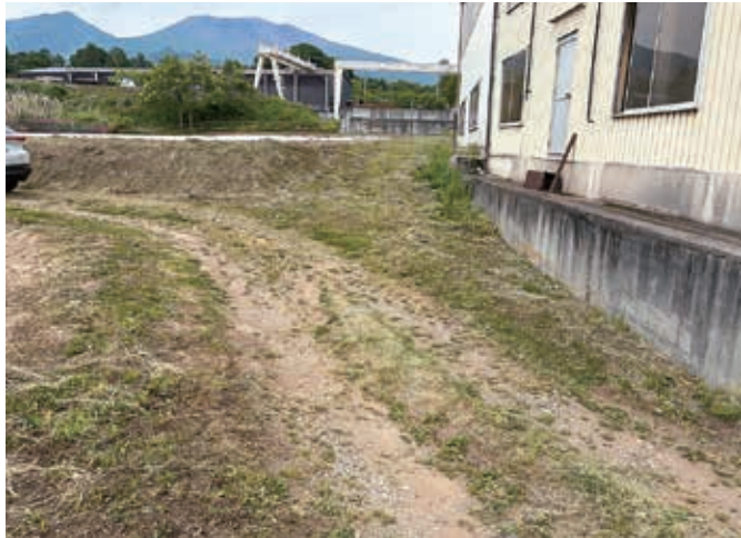
道路機能喪失と説明のあった町道の一部。 農繁期は農家が毎日使用している。
