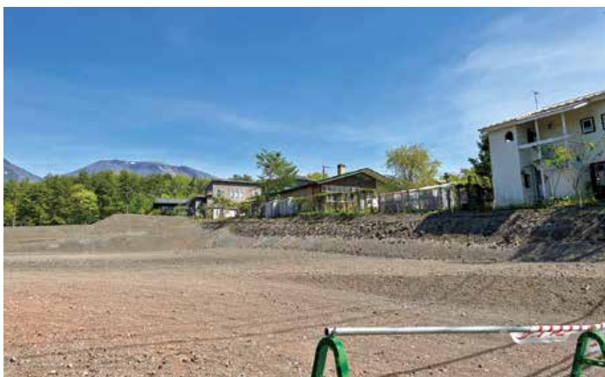
皆伐後に事業が中断している開発地。開発後の修景植栽が重要だ
