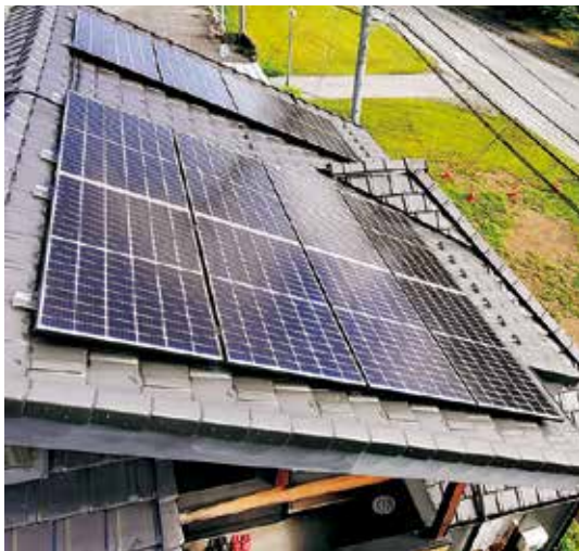
太陽光発電システムは安価になったが蓄電池は未だ高価なため設置できない
